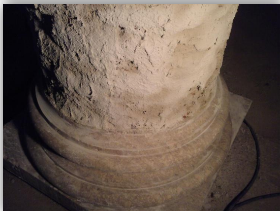
FIGURA 123 - PARTICOLARE DELLA BASE DELLA COLONNA, SULLA QUALE È STATO APPLICATO IL RINZAFFO
