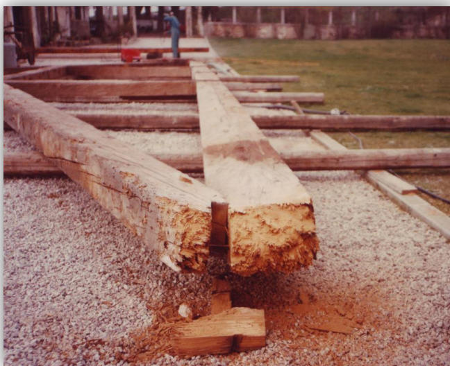
FIGURA 41 - STATO DELLA TESTA DELLA CAPRIATA
